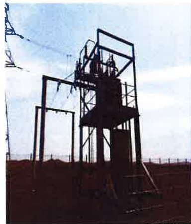
Тэжээлийн үйлдвэрийн 35,04н цахилгаан станц
